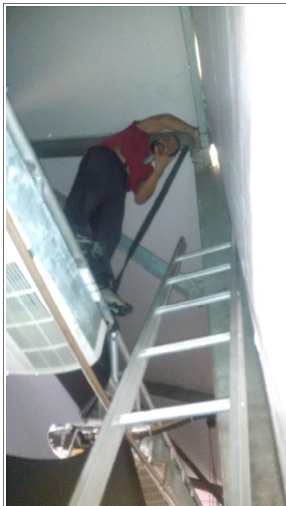
Gustavo instalando Access Point na tenda da SBPC Jovem
