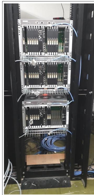
O rack com 3 magazines da nova Central Telefônica da Reitoria
