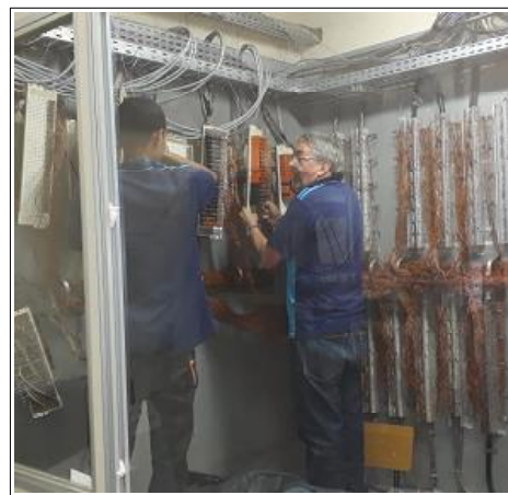
Os Técnicos da TeleAlpha, Carlos e Sizomar Falcão, realizando a instalação do distribuidor geral de ramais da sala de Telecomunicação no ICEx
