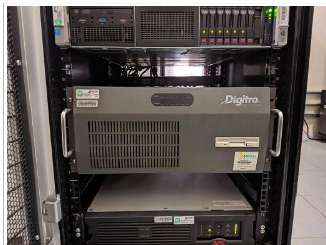
PABX Digitro que foi substituído
