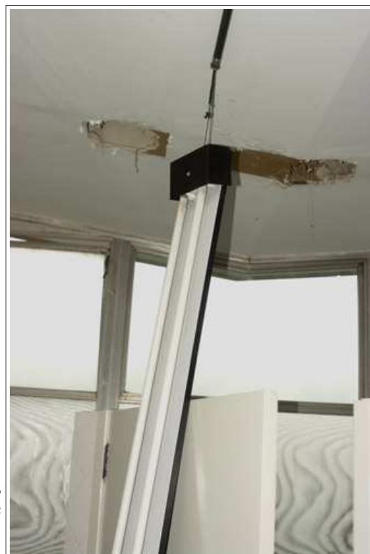
Buracos foram abertos no teto do banheiro feminino para saída da água
