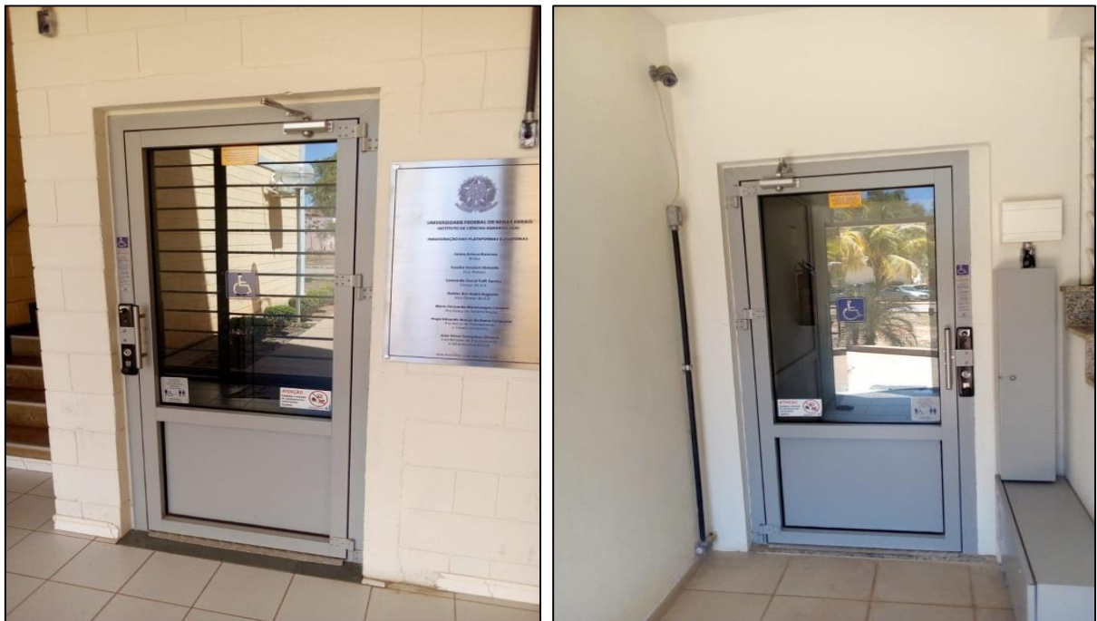
FIGURA 11 - PLATAFORMAS ELEVATÓRIAS INSTALADAS EM 2018 NO BLOCO C (FOTO À ESQUERDA) E NO PRÉDIO DA FUMP (FOTO À DIREITA).
