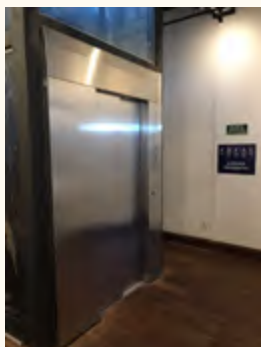
Figura 2 - Elevador situado na parte interna do prédio do Museu.
