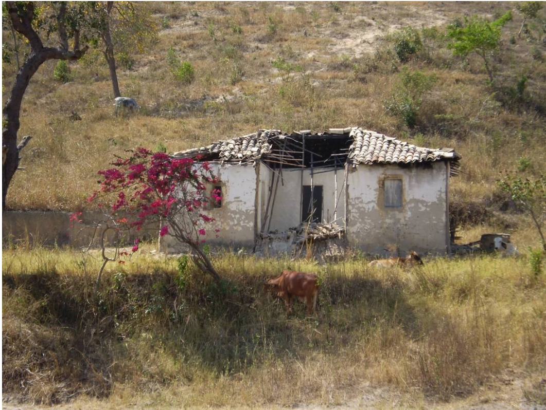
Figura 7: casa abandonada em Ribeirão de Capivara
