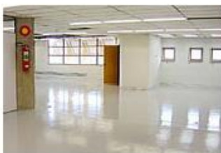
Piso seco após 72 horas (sala)
