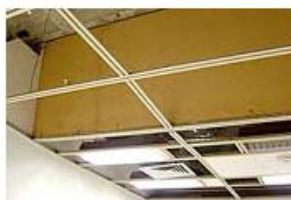
Forro sem cobertura
