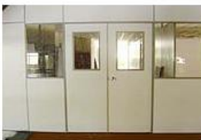
Porta dupla instalada
